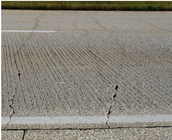
a) Y-crack (147+46 EB)
