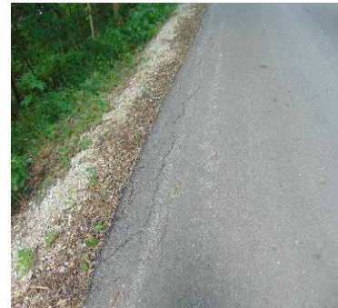
(d) Edge cracks
